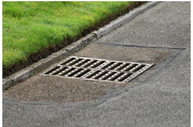
Figura 78: Os bueiros ou bocas-de-lobo são a porta de entrada do sistema de drenagem das vias públicas. Foto: © Patrick J./ Fotolia.
