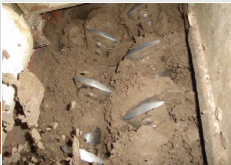
Foto 37: Vazamento de ar pela portinhola da grelha
